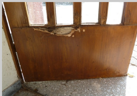
Die Schäden an der Türe waren auf der Innenseite noch deutlicher zu sehen.
