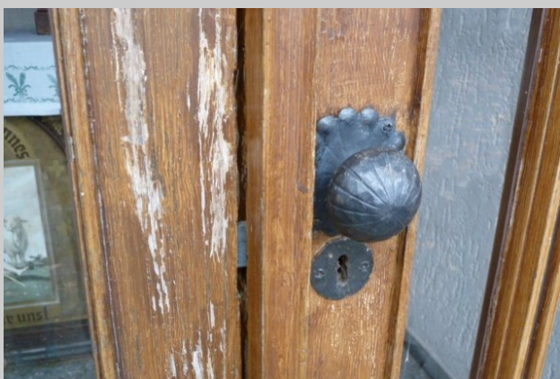
Oktober 2012: Der Spalt zwischen den Türflügeln wurde immer größer und die Türe ließ sich nicht ordentlich verschließen.
